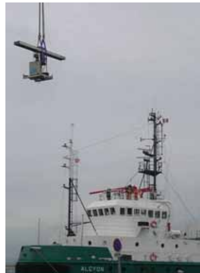
Installation du radar SeaDarq sur l'Alcyon
