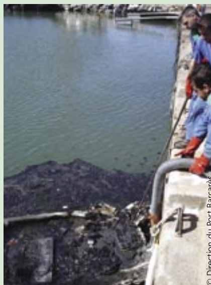
Pompage par camions d'aspiration par le vide et récupération manuelle dans un bassin portuaire
