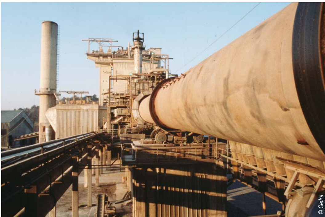
La co-incinération en cimenterie permet de limiter le coût de l'incinération par la valorisation matière ou énergétique. Mais les contraintes d'accès et l'implantation des unités souvent loin du littoral réduisent leur intérêt en cas de marée noire.
